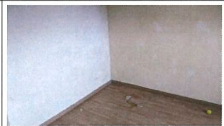
Dégât des eaux (1er)
